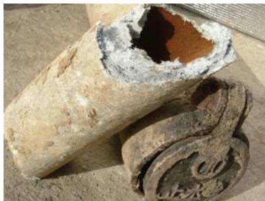
破損した石綿管（イメージ）
