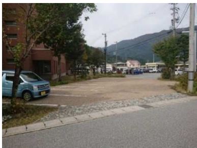
老朽化した駐車場の舗装
