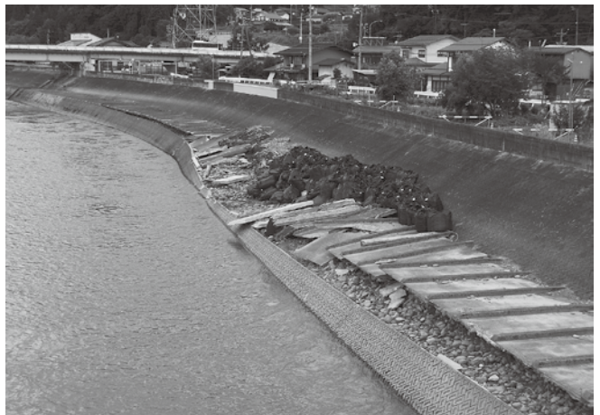
一級河川宮川の護岸が約 200m に渡り被災しました。(古川町高野地内)
