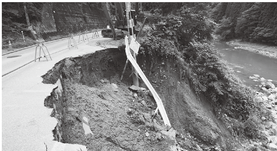
国道471号 路肩崩壊（宮川町小谷地内）
