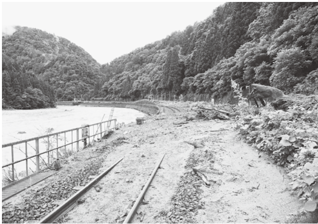
JR 高山線に土砂が流入 (宮川町打保地内)
