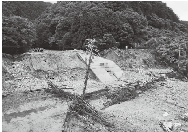
宮川町牧戸地内の JR 高山線は 150m に渡り土砂の流出により線路が流失しました。
