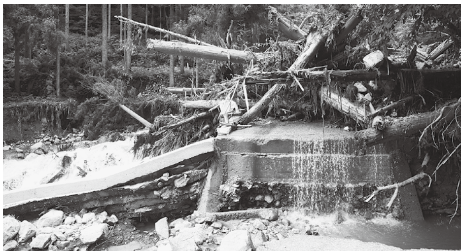
市道小谷線 流木の流出状況（宮川町小谷地内）
