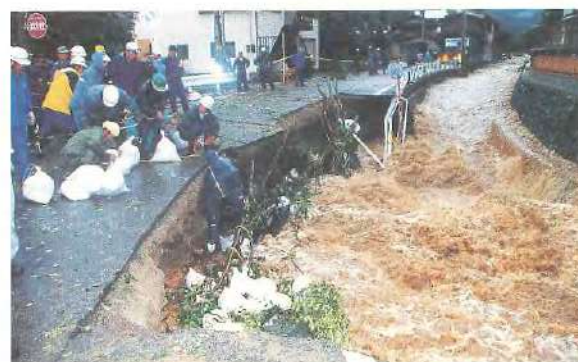
道路が決壊し、土のうで補強
