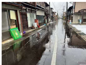
▲神岡町消雪設備（R6施工）
