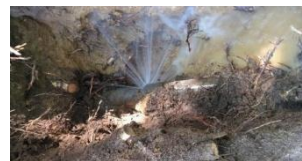
▲石神地内 石綿管漏水状況
