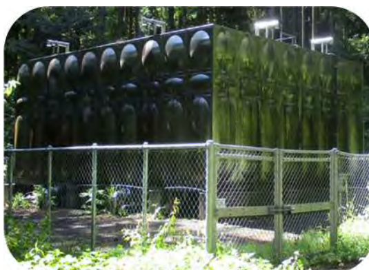
宮川第1配水池(SUS造)
