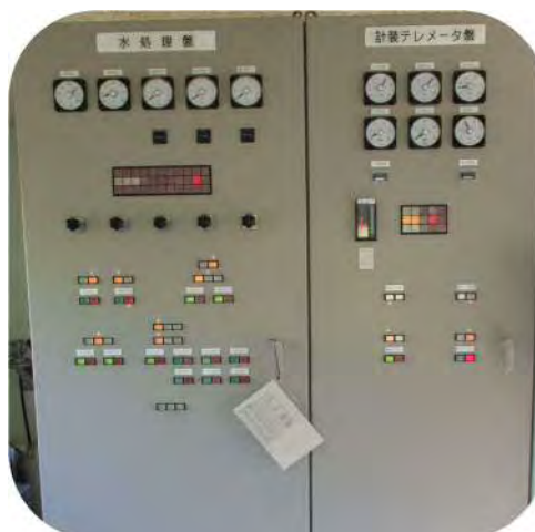
水道施設監視装置
