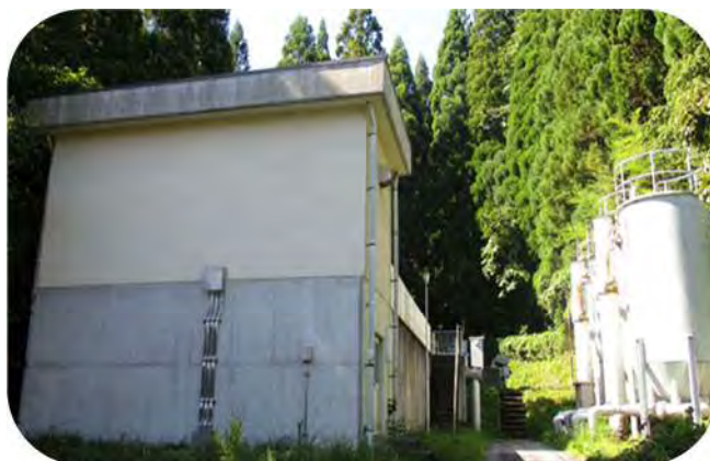
梨ヶ根浄水場（急速ろ過）
